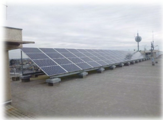
市役所屋上の太陽光発電
