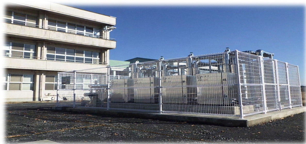
栃木県農業大学校の地中熱利用システム
