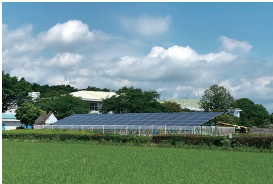
【小学校に設置された太陽光発電施設】
