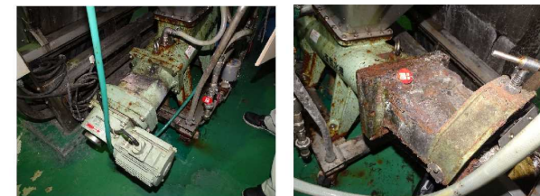
No. 50006_し渣脱水機
