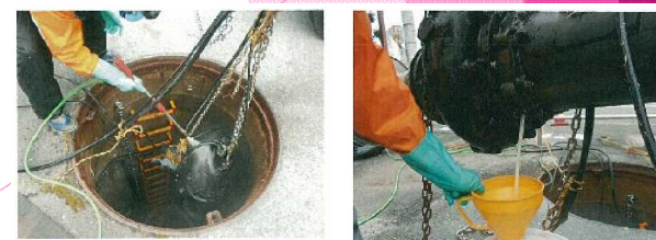
No. 56001_着脱式水中汚水ポンプ No. 56002_着脱式水中汚水ポンプ
