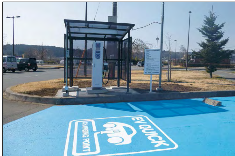
【道の駅きつれがわに設置した電気自動車用急速充電器】
