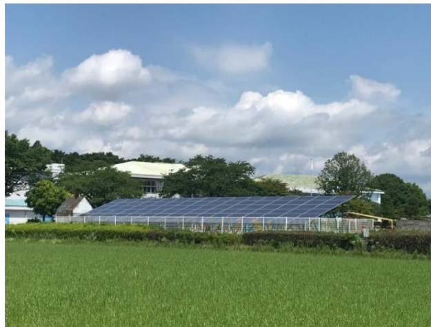
【押上小学校太陽光パネル】
