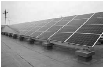
太陽光発電・蓄電設備
