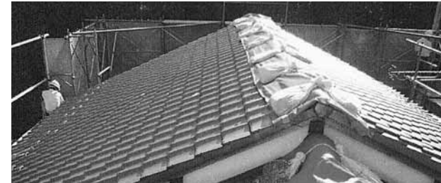
震災被害例（屋根）
