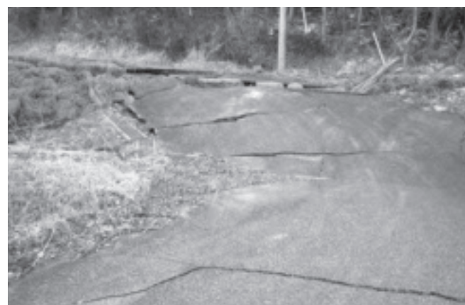
破損した道路（穂積地区）
