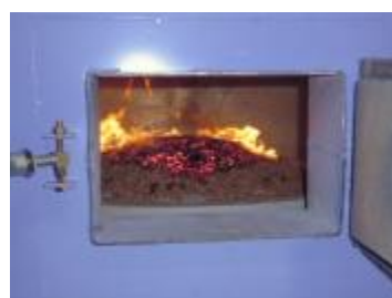
バイオマスペレット燃焼状況
