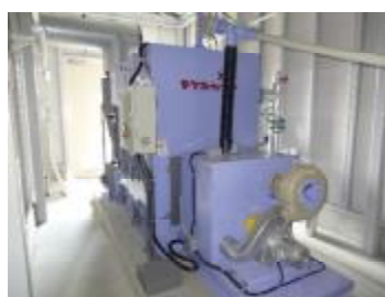
バイオマス燃料ボイラー
