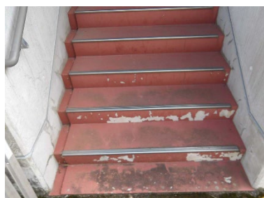
階段 塗装の剥がれ、汚れ
