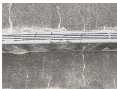
入口階段 ひび割れ、欠損
