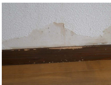
室内 壁紙の剥がれ
