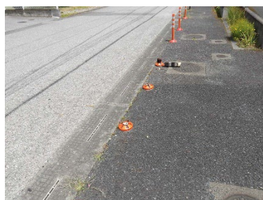
接道境界 ポール欠損
