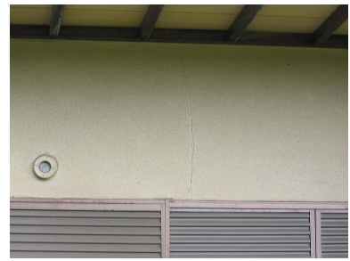
外壁 ひび割れ
