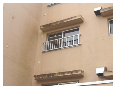
外壁・庇 汚れ
