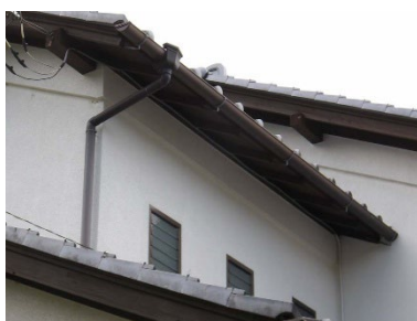
屋根・軒裏 若干の汚れ
