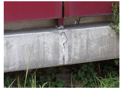
外壁のひび割れ
