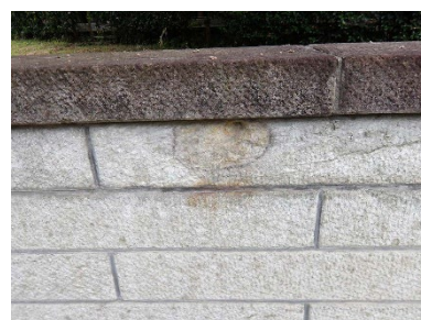
集会所 擁壁 欠損、錆水
