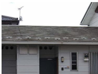
屋根・広範囲に汚れ
