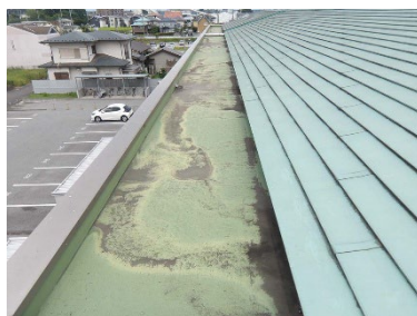
屋上・屋根 滞水跡
