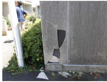
物置 外壁の欠損
