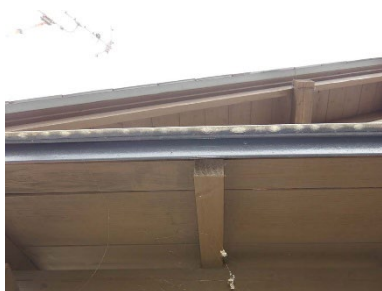
バルコニー上部・庇 樋の変色
