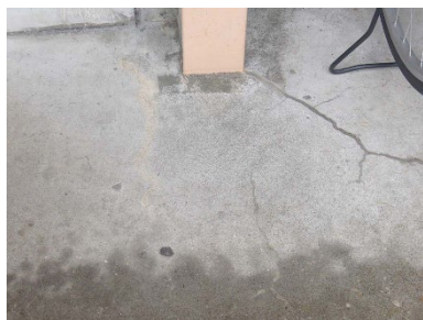
階段室 床にひび割れ
