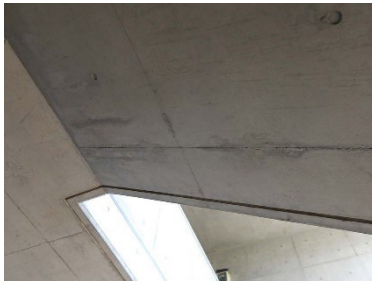
階段室 天井にひび割れ、腐食
