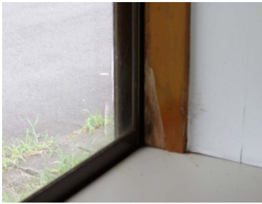
室内 開口部 木枠の破損
