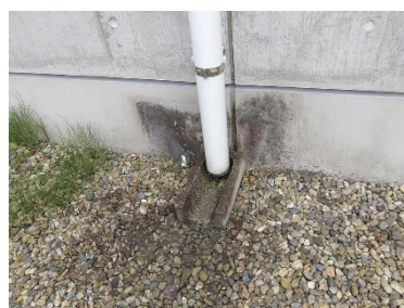
外壁 腐食、汚れ
