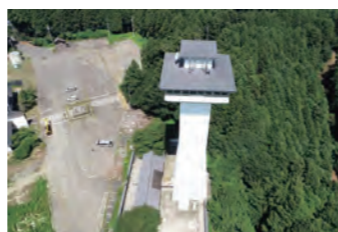
喜連川スカイタワー被災・劣化調査事業
