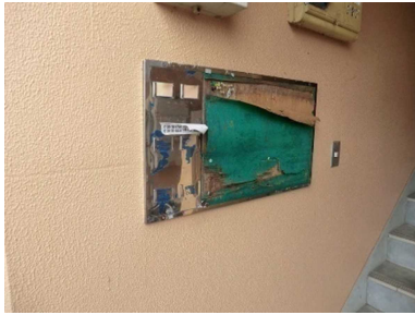
掲示板の劣化
