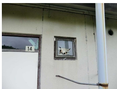
開口部・ガラス窓破損
