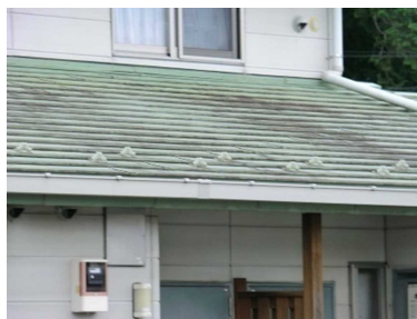
屋根・広範囲に汚れ
