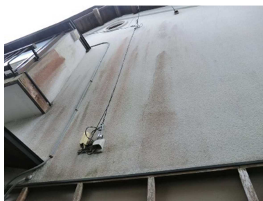
外壁の広範囲に汚れ
