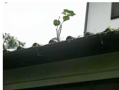
雨樋に植物の繁茂
