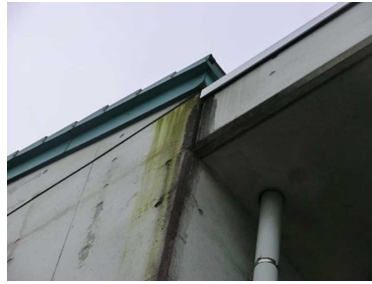
外壁に汚れ・苔の発生
