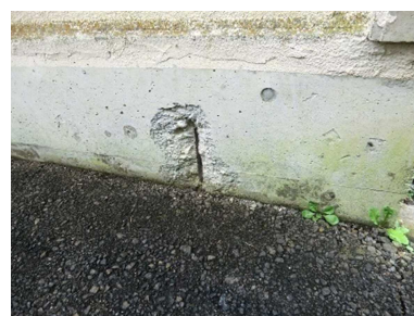
基礎に欠損・鉄筋の露出
