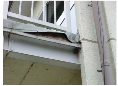
バルコニーの防水シート浮き・めくれ
