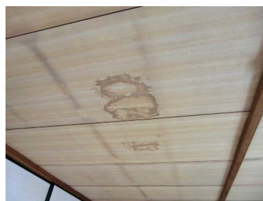
[空家]天井に漏水跡
