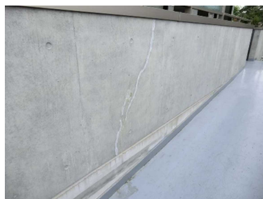
外壁の補修跡
