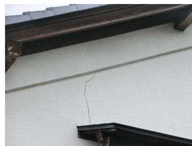
外壁のひび割れ
