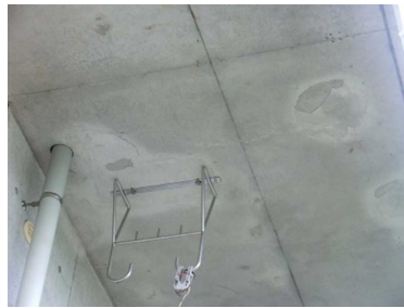
軒裏の漏水跡
