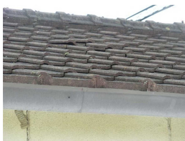
屋根・瓦の浮き
