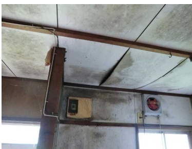
[空家]台所の天井にたわみ
