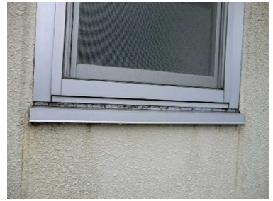
開口部 シーリング材の劣化
