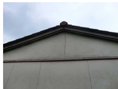
外壁のひび割れ
