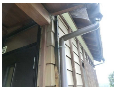
[空家]雨樋・後ろ柱の腐食
