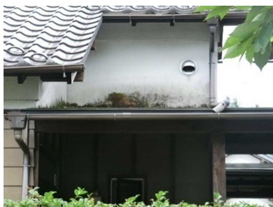
外壁の広範囲に汚れ
