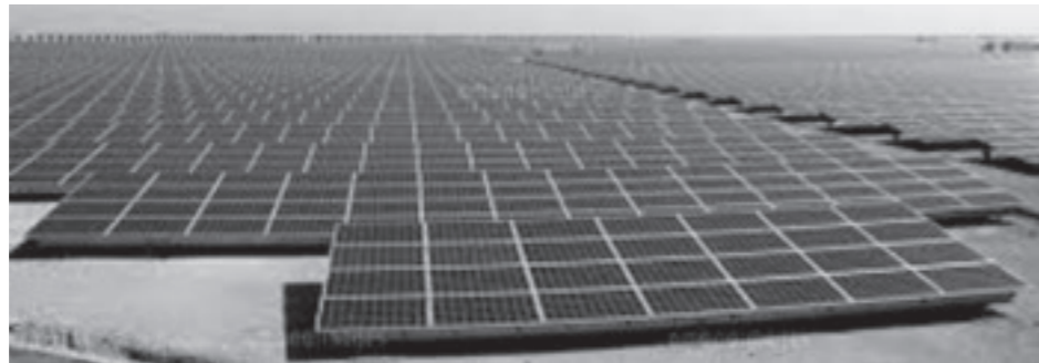
太陽光発電設備
