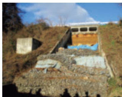
豪雨被災箇所 (上阿久津台地区画整理事業地内調整池)
