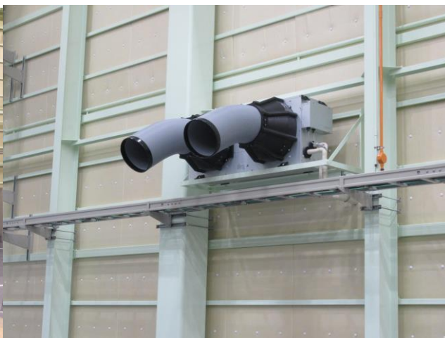
（壁に取り付けられたエリア空調）
