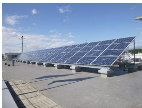
【市役所本庁舎屋上に設置の太陽光発電パネル】
