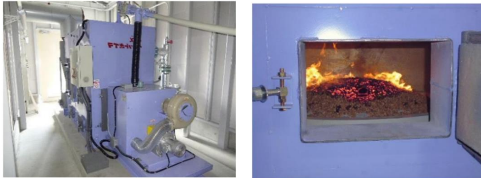
図 6-8 もとゆ温泉に設置のペレットボイラー ※16
